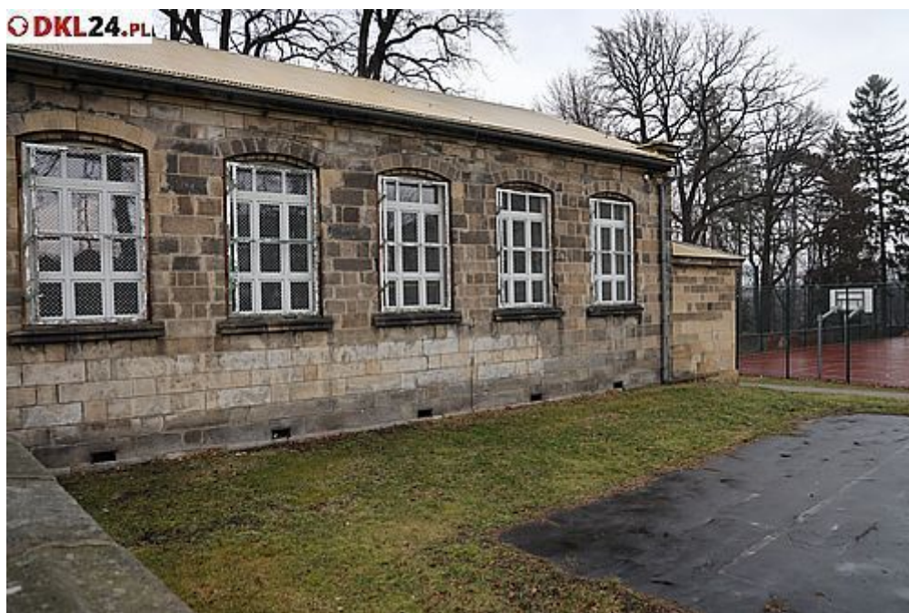
Sala gimnastyczna ogólniaka ma za sobą lata eksploatacji
